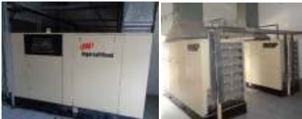
Фиг. 1. Компресорна станция
